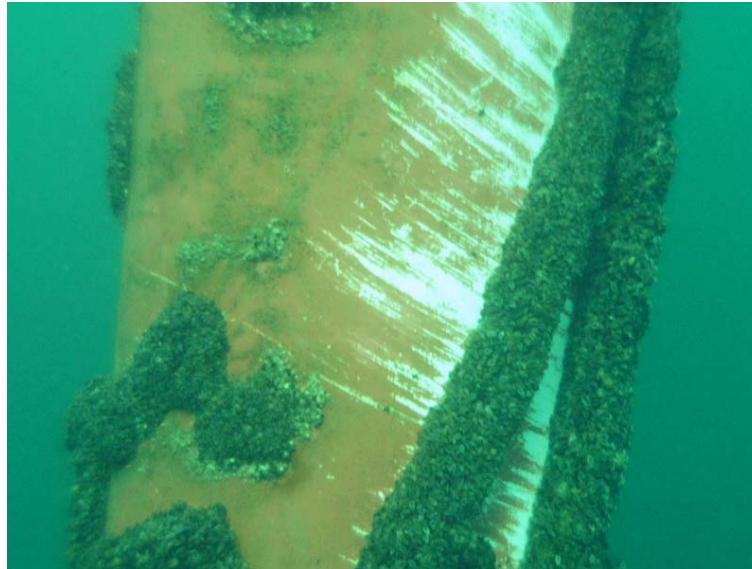
Abb. 4.8.: Schleifspuren an der Mastoberfläche durch die Bewegung der bewachsenen Kabel
